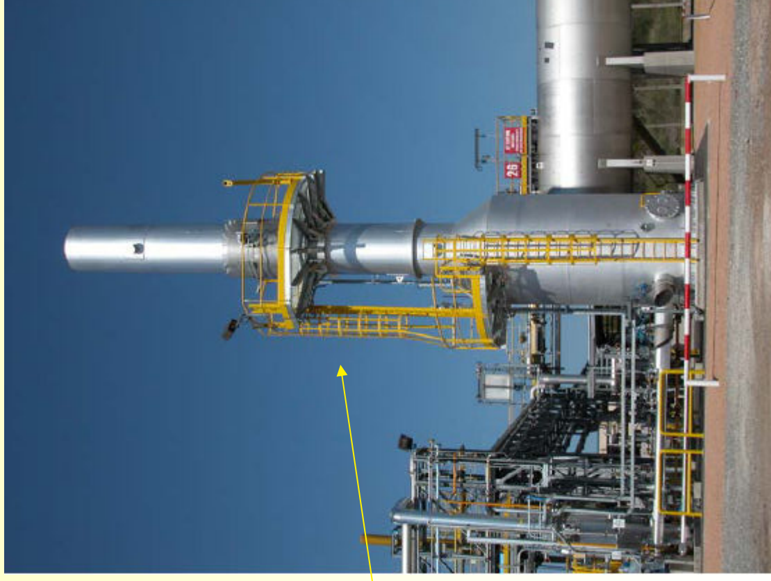
Incinerador vertical tiro natural
